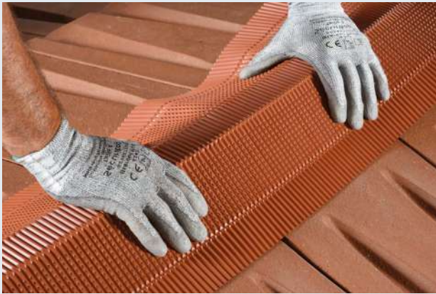
1- Après avoir positionné la lisse de rehausse dans l'axe du faitage, dérouler et positionner le closoir sur celle-ci.
