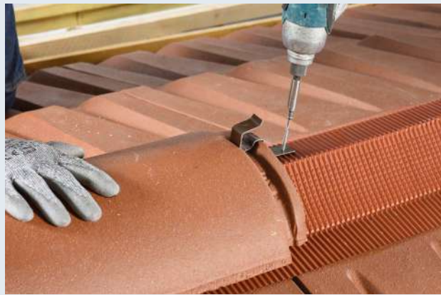
4- Positionner et fixer les faitières de manière à ce que les recouvrements soient opposés aux vents dominants.
