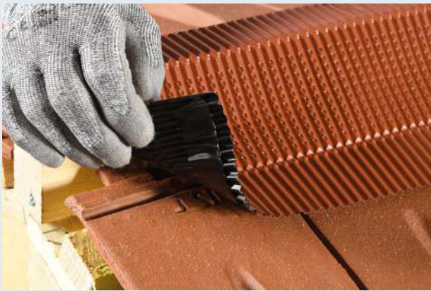
3- Retirer la bande de protection butyle à l'avancement, presser et maroufler les bavettes sur les tuiles.
